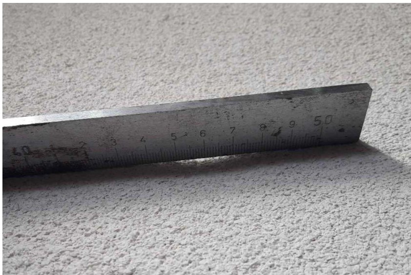
Foto A1: Detalle de la hendidura por el impacto
